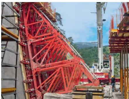
Le principe de raccordement solidaire employé permet de déplacer l'ensemble en une seule opération.
