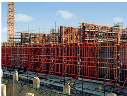
Installation de dessalement Kurnell, Sydney, Australie
